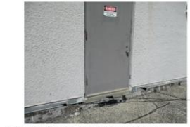
C1 DOOR FLASHING PHOTO
